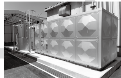
廃温水タンク
